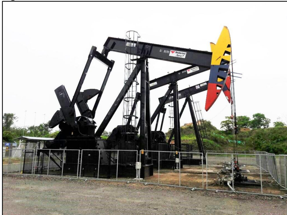
Figura 16. Unidad de bombeo convencional, Bombeo Mecánico.
