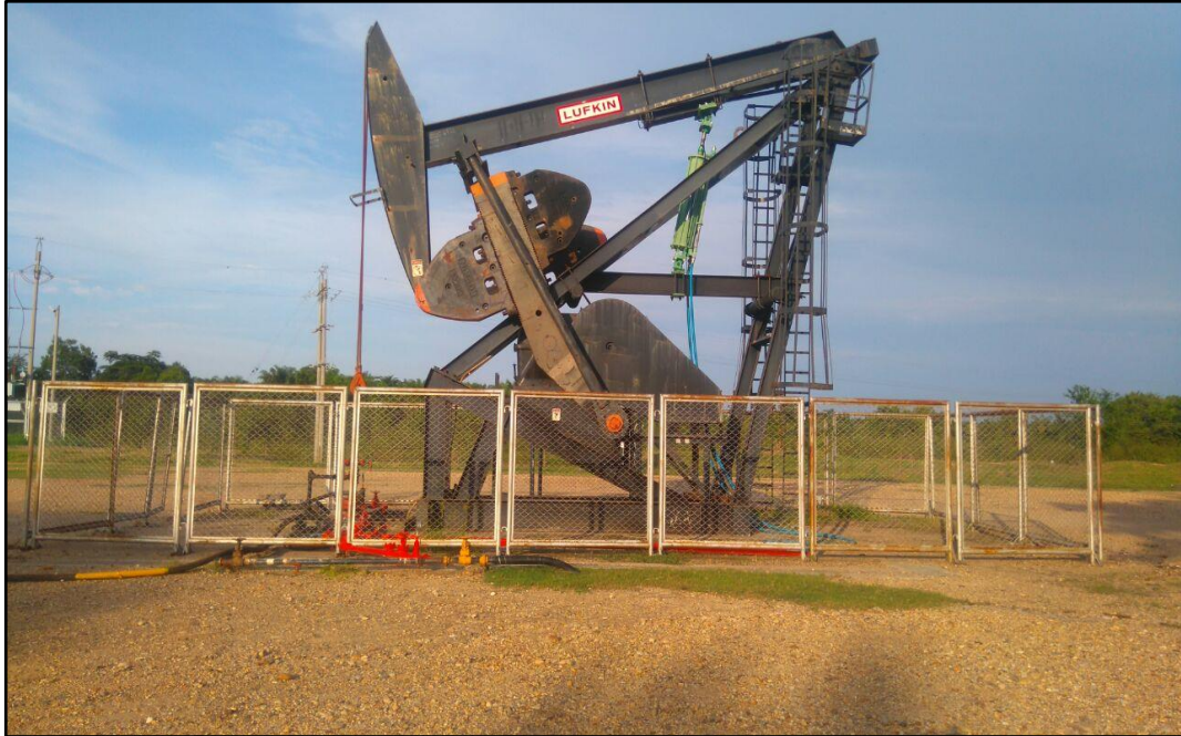
Figura 18. Unidad Unitorque Mark 2, Bombeo Mecánico.
