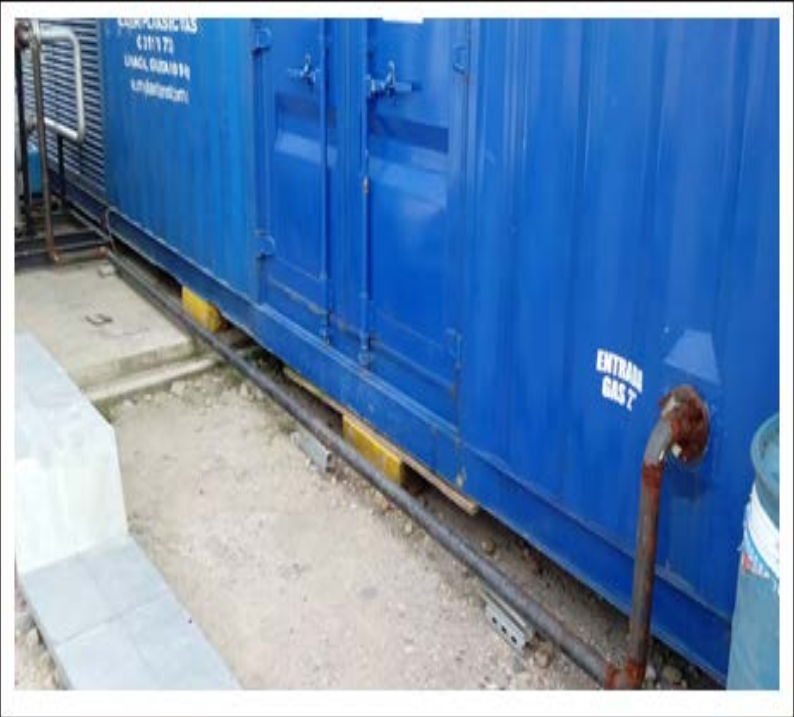
Figura 25. Entrada de gas por línea de 2 in al generador.
