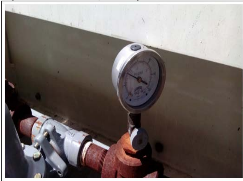
Figura 31. Presión de operación generador.
