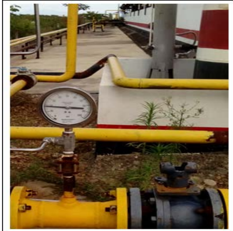
Figura 27. Presión operación scrubber.
