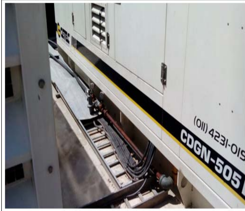
Figura 30. Entrada de GLP al generador por línea de 2".
