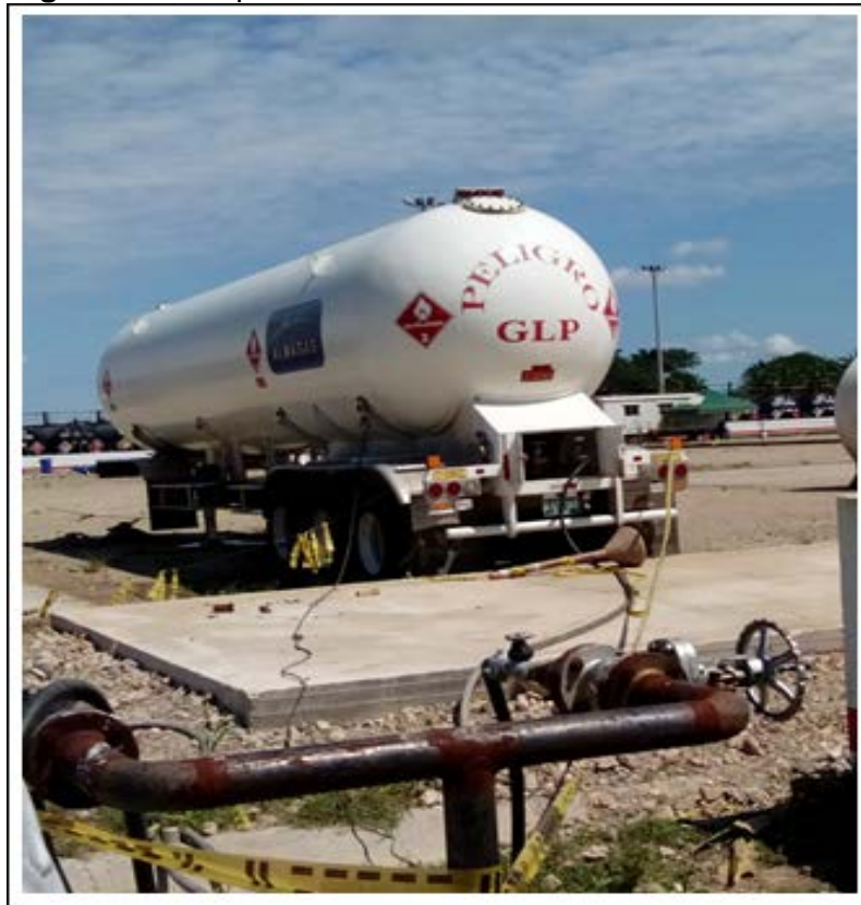
Figura 29. Tanque de almacenamiento GLP.
