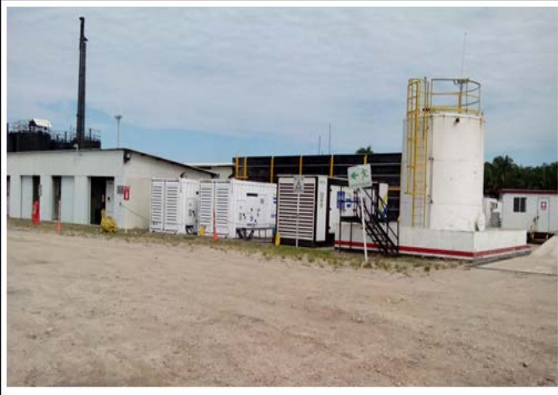
Figura 33. Tanque de almacenamiento para fuel oil N° 4 y generadores.
