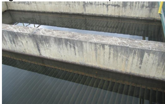
Figura 10. Sedimentadores de placas inclinadas
