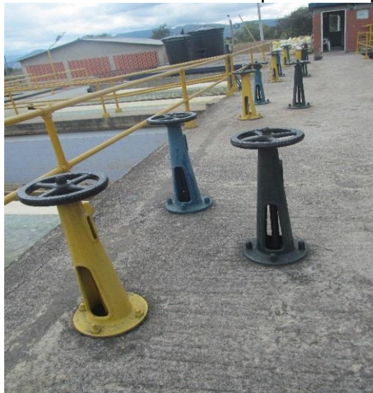
Figura 16. Válvulas de control planta compacta.
