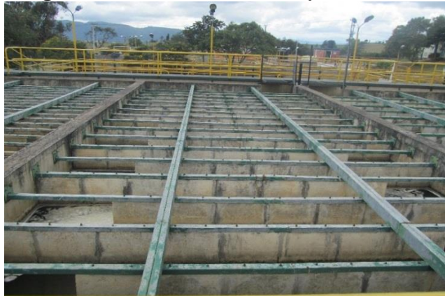
Figura 9. Floculadores de flujo horizontal.
