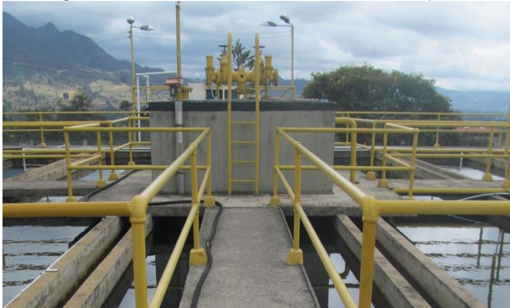
Figura 12. Estructura bomba de vacío de Planta Compacta
