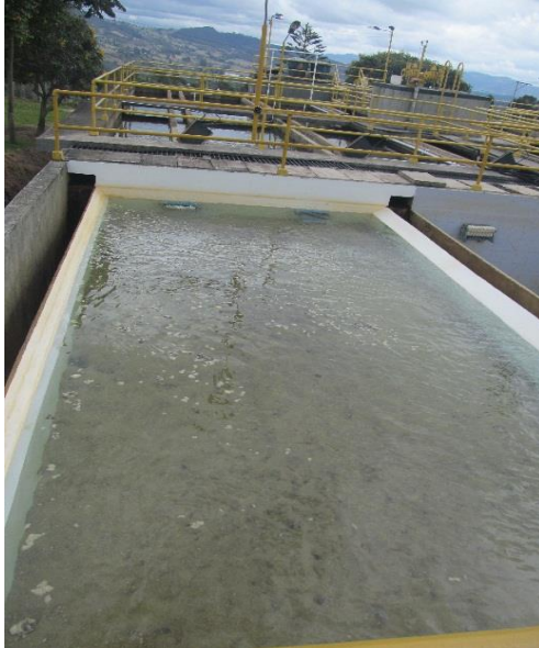
Figura 14. Filtración del agua.
