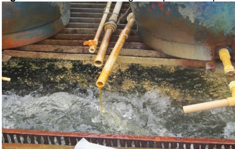
Figura 11. Suministro de coagulante planta Compacta.
