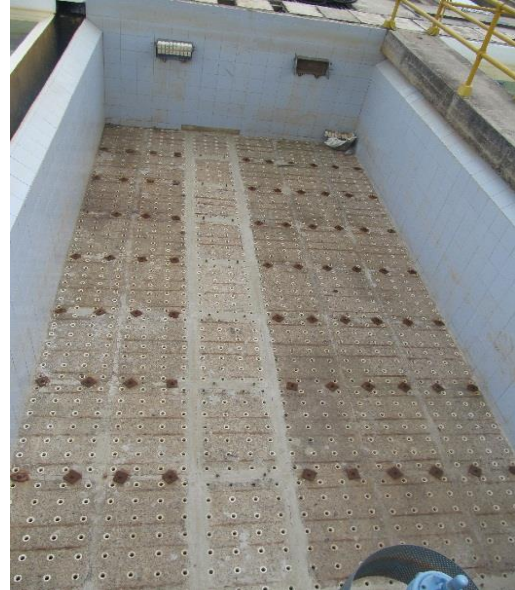
Figura 15. Estructura de filtros
