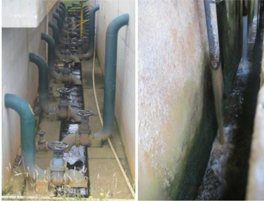
Figura 13. Desagüe de lodos de planta convencional y compacta.
