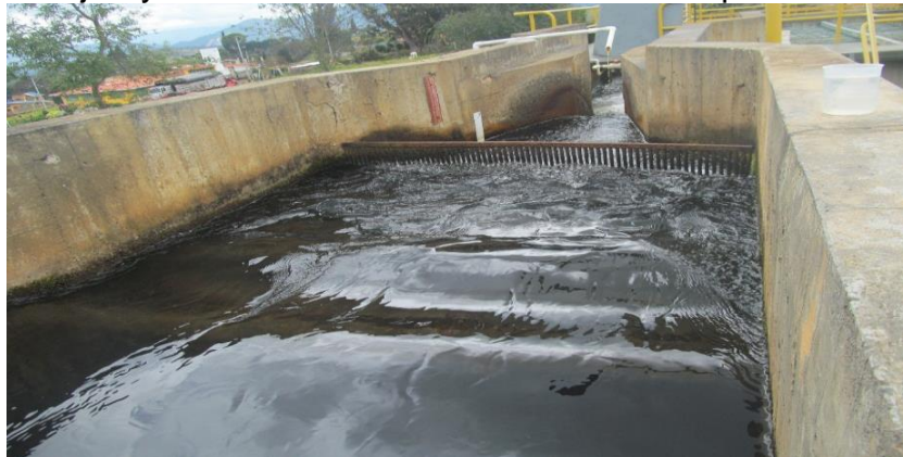
Figura 7. Rejilla y canaleta Parshall a la entrada de la planta convencional.
