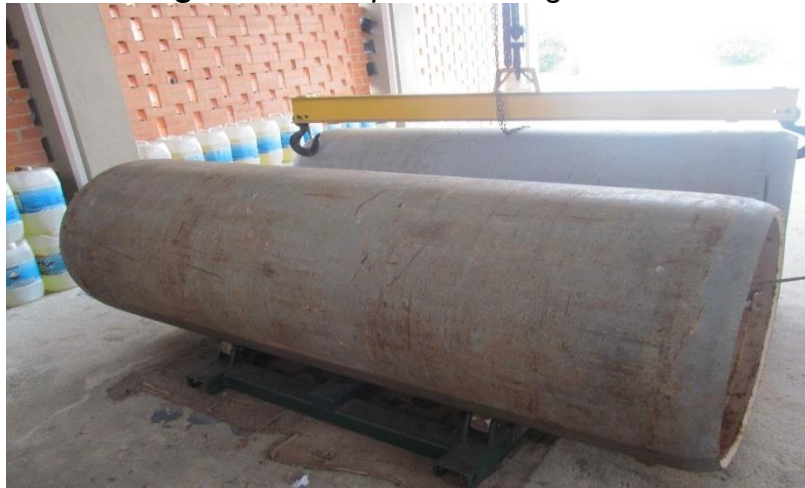
Figura 17. Tanque de cloro gaseoso.
