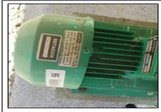
Figura 17. Bomba planta Mantovani.
