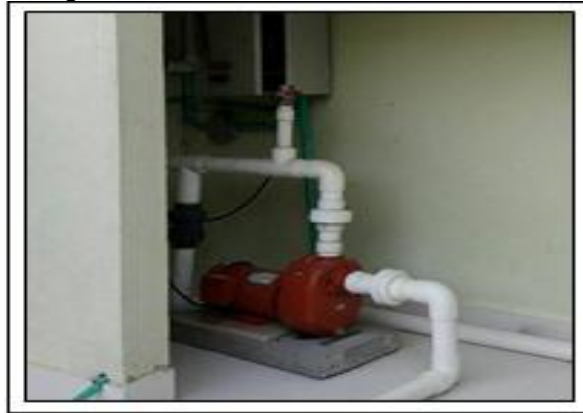
Figura 15. Bomba conectada de las trampas de grasas a los tanques de floculación y coagulación.
