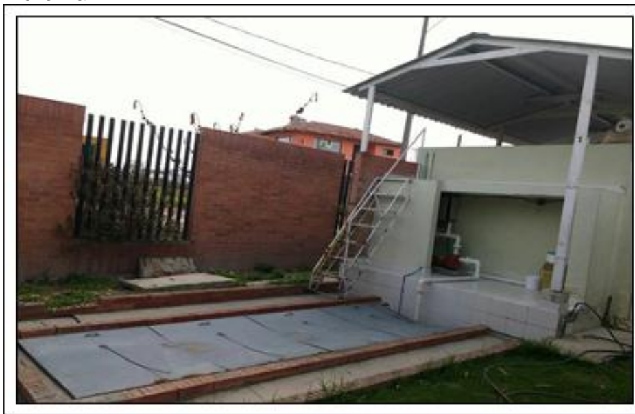
Figura 9. Planta de tratamiento de aguas residuales de lácteos Levelma.
