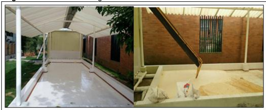
Figura 14. Piscina de lodos/grasas.
