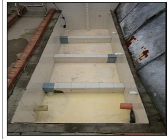
Figura 11. Vista superior de las cuatro trampas de grasas.
