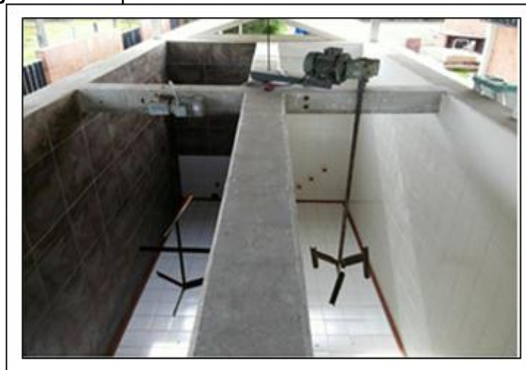
Figura 13. Tanques de clarificación.
