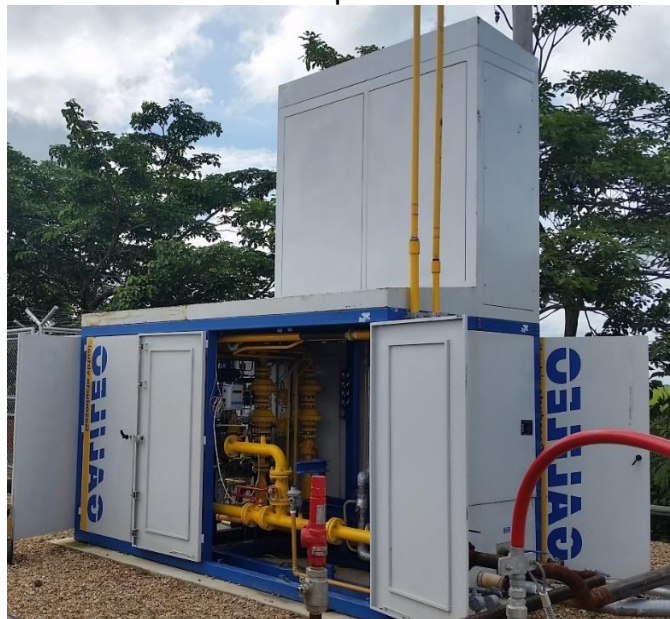
Foto 3. Unidad descompresora de Gas PRP
