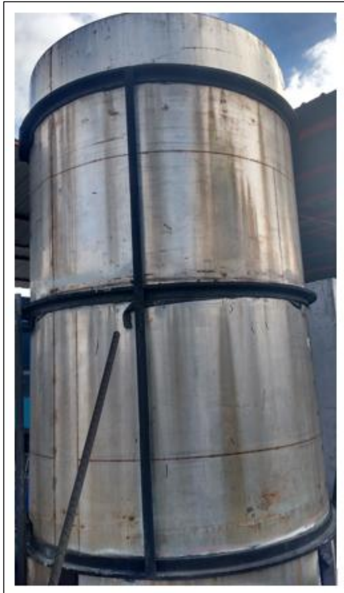
Figura 8. Tanque de igualación de caudales, pH y temperatura.
