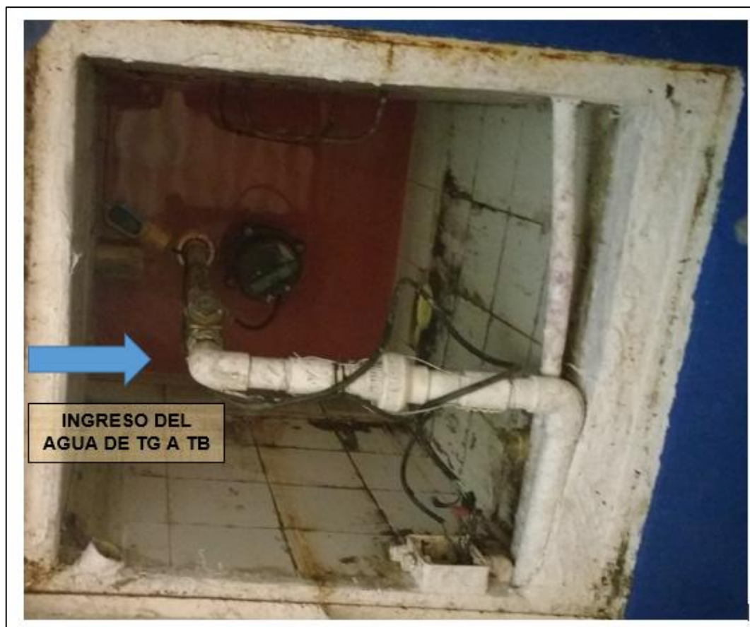
Figura 7. Esquema de entrada del agua desde la trampa de grasas (cámara 2) al pozo del bombeo.
