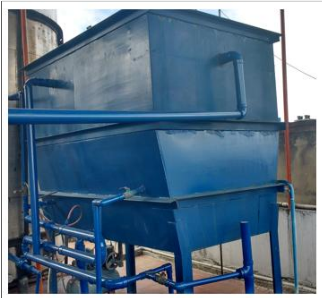
Figura 9. Tanque de tratamiento fisicoquímico, clarifloculador.
