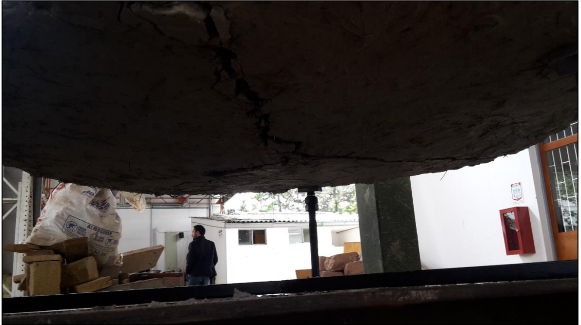
Foto 46. Fractura en la parte inferior
