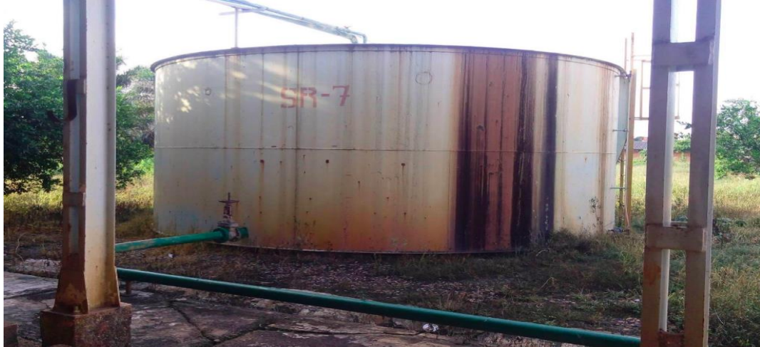
Imagen 10. Tanque de post-cloración y almacenamiento de agua tratada
