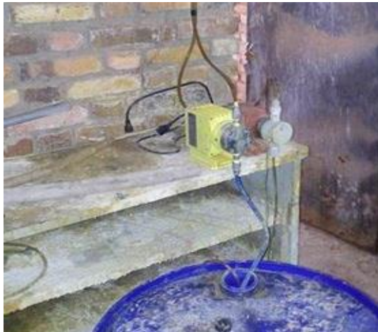
Imagen 5. Bomba dosificadora de sulfato de aluminio e hipoclorito de sodio
