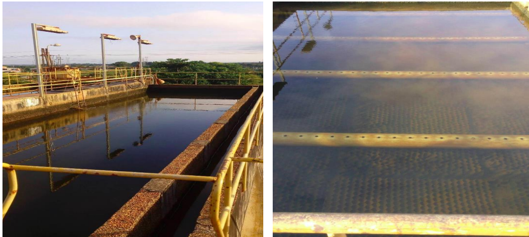
Imagen 7. Tanque de almacenamiento de agua clarificada
