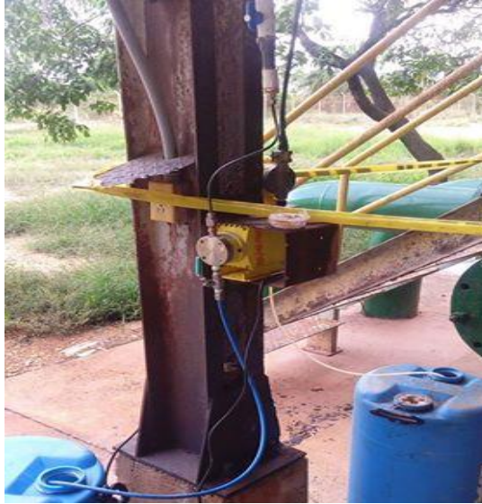
Imagen 4. Bomba dosificadora de soda cáustica
