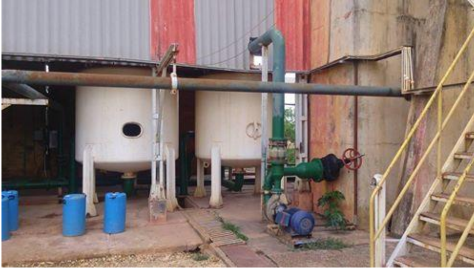
Imagen 8. Bomba de agua clarificada
