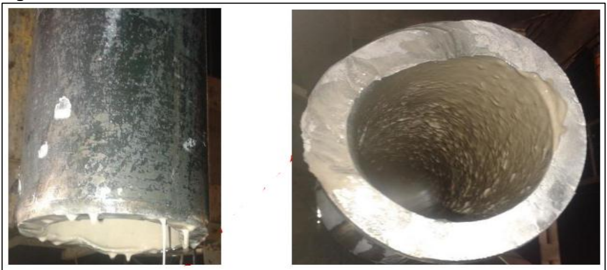
Figura 56. Junta Fallada de la sarta del Pozo K.
