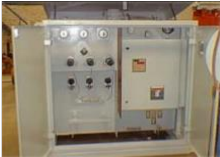
Figura 15. Transformador para el Bombeo Electrosumergible.
