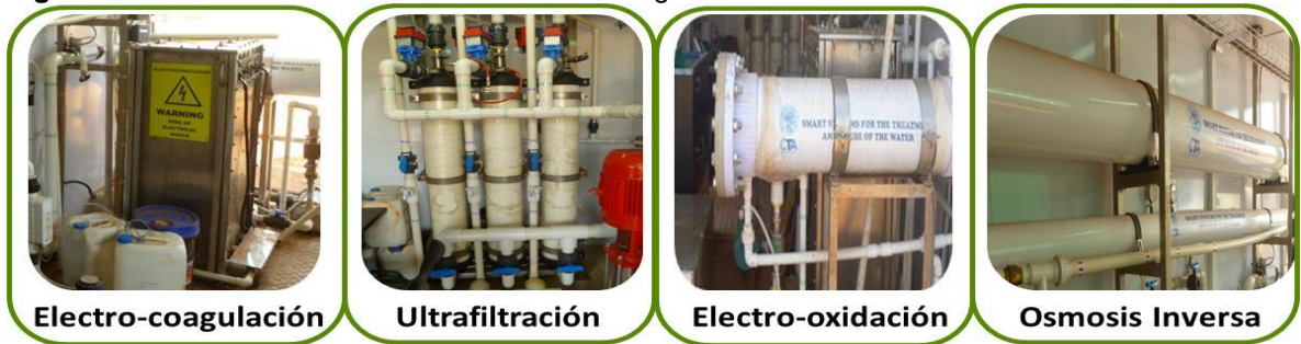
Figura 7. Sistema de Tratamiento Avanzado de Aguas.
