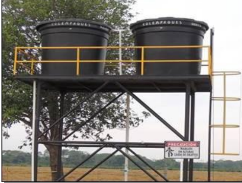
Figura 9. Tanque de almacenamiento de agua tratada antes del vertimiento.
