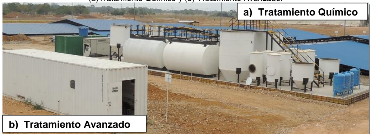
Figura 5. Ubicación de los sistemas de tratamiento de aguas dentro de la Planta El Recreo (a) Tratamiento Químico y (b) Tratamiento Avanzado.
