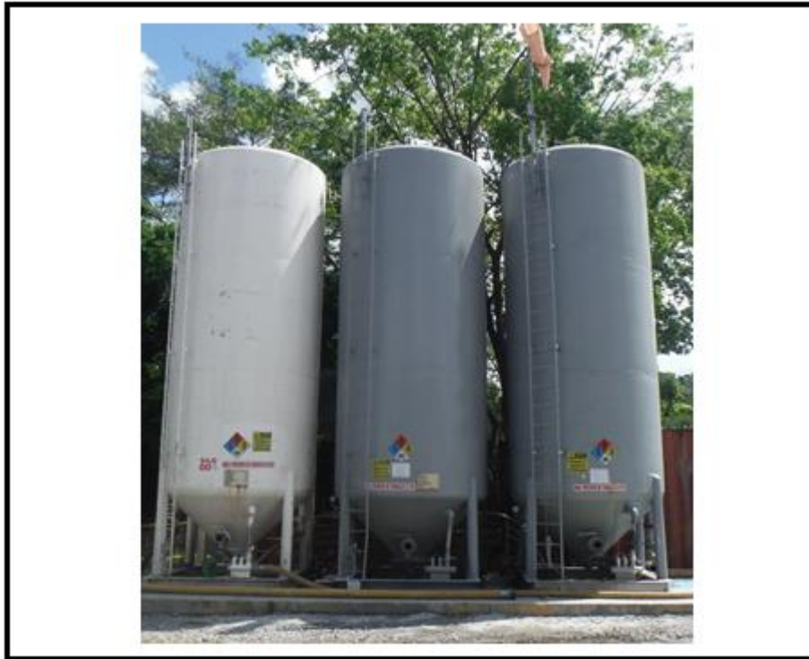
Figura 16. Silo almacenador de cemento.
