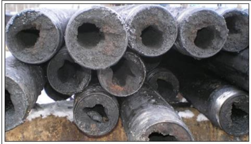
Figura 7. Reducción del diámetro efectivo de la tubería causado por la deposición de asfáltenos.
