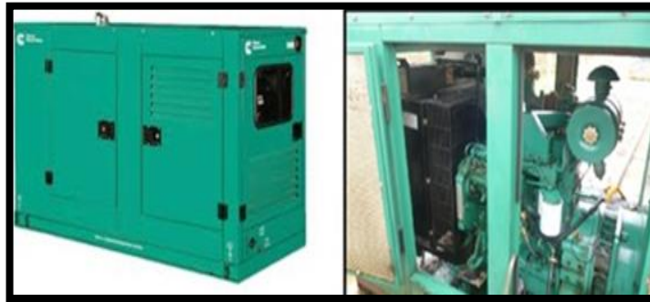
Figura 4. Generador Eléctrico de PGS S.A.S
