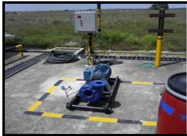
Figura 6. Bomba de Transferencia Hidromac 20 HP
