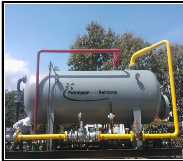
Figura 5. Separador Trifásico de PGS S.A.S
