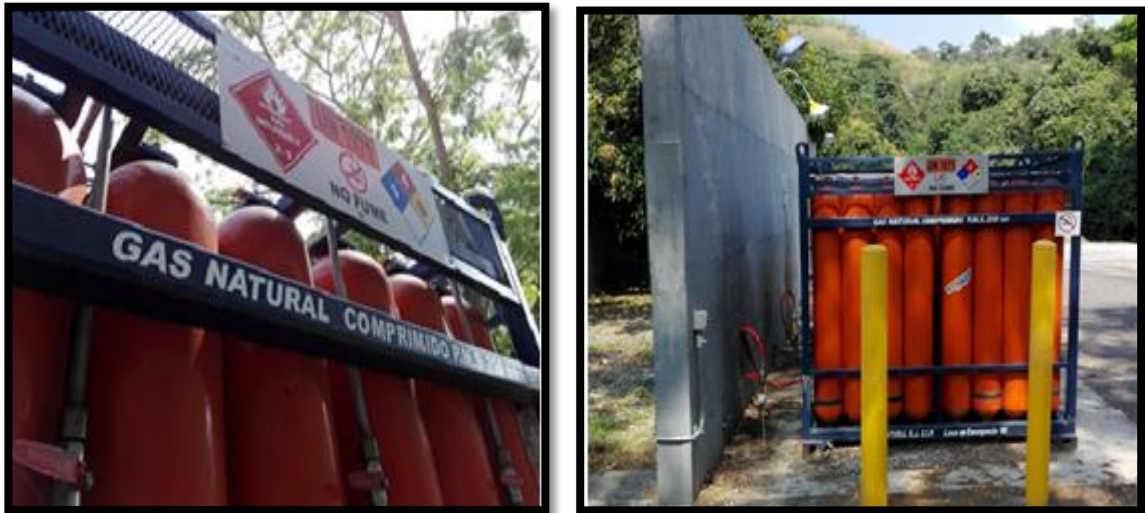
Figura 2. Módulo de Gas Natural Comprimido
