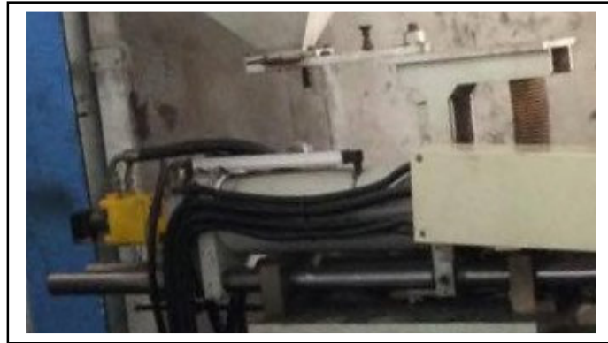
Imagen 3. Unidad de potencia
