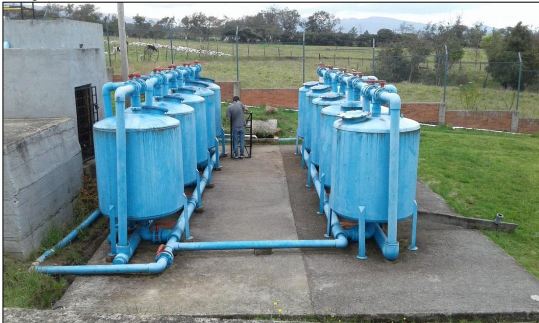
Imagen 20. Infraestructura batería de filtros de la PTAP
