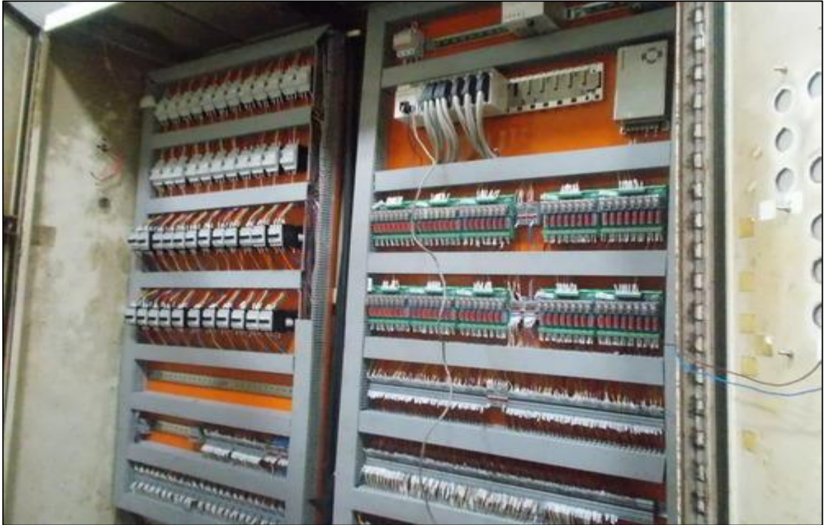
Imagen 22. Placa panel de control PLC
