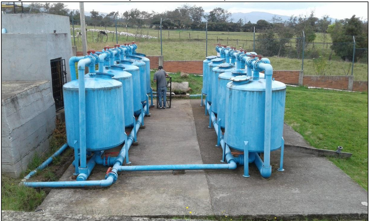
Fuente: Planta de tratamiento de Guasca
