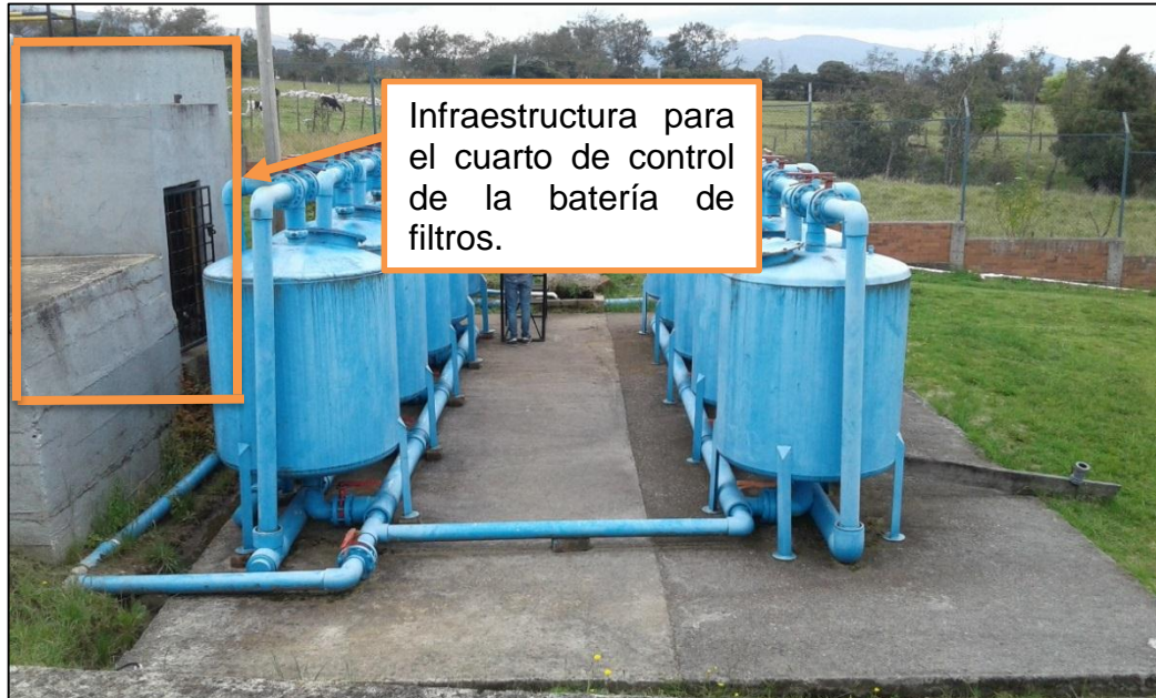
Imagen 21. Infraestructura cuarto de control de batería de filtros de la PTAP
