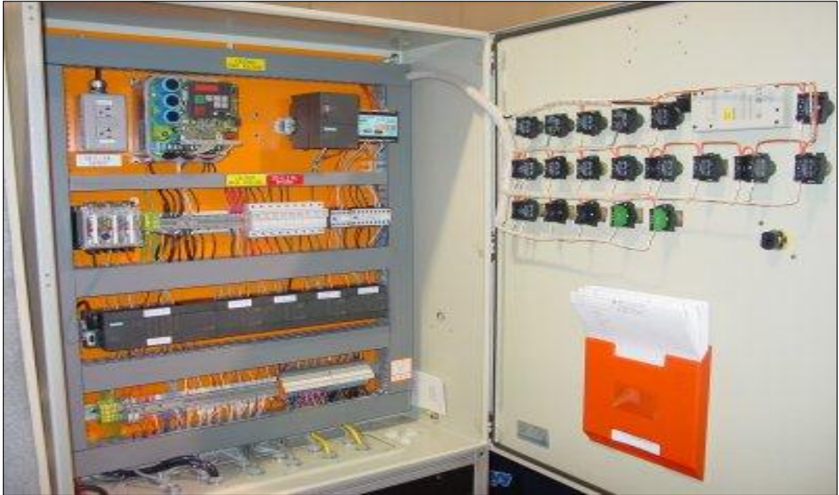
Imagen 17. Tablero eléctrico de control con PLC
