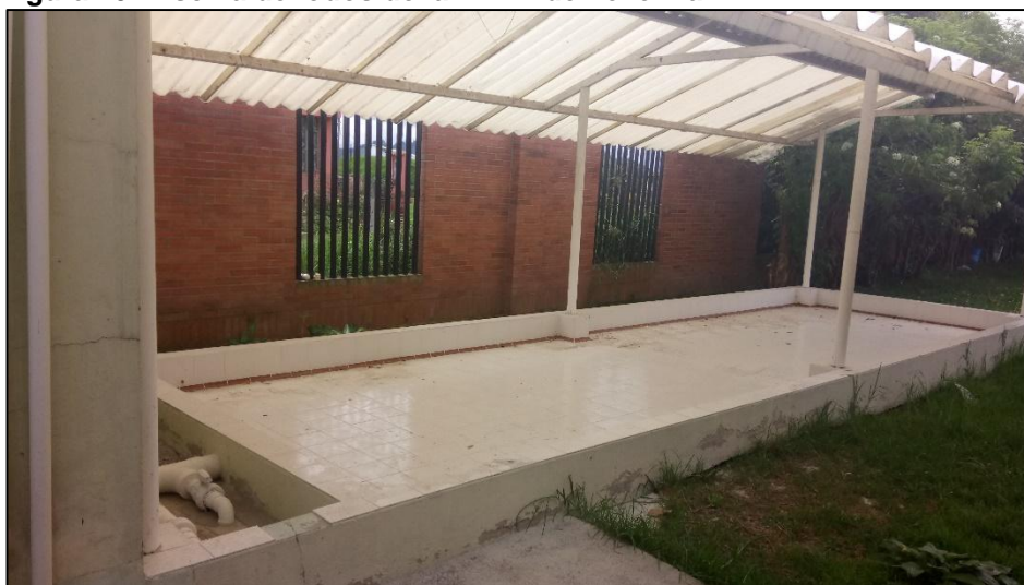
Figura 10. Piscina de lodos de la PTAR de Levelma.
