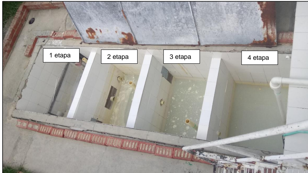
Figura 8. Trampa de grasas de 4 etapas, ubicada en el costado norte de la planta de producción LEVELMA.
