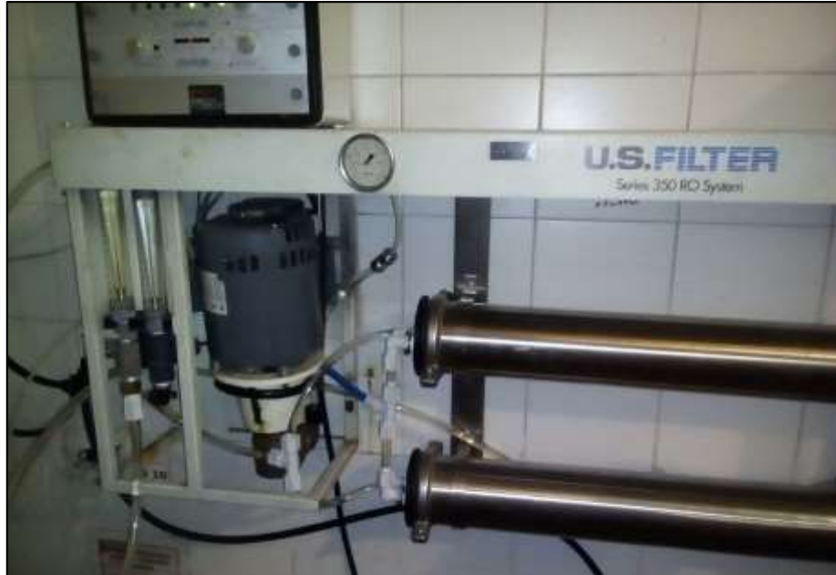
Imagen 8. Equipo de osmosis inversa
