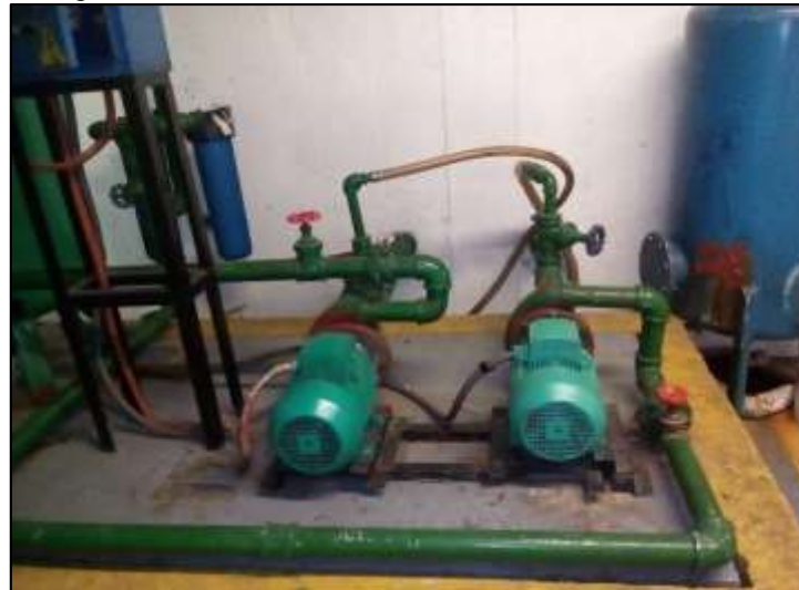
Imagen 3. Bombas sistema hidrodinámico.
