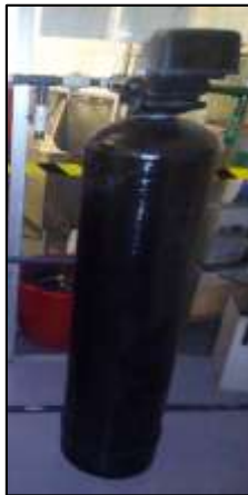
Imagen 5. Filtro de carbón activado
