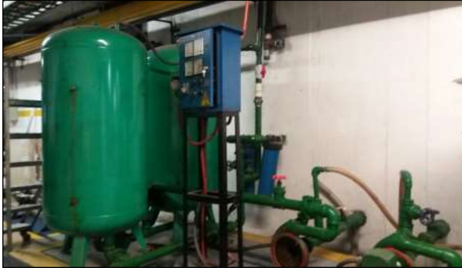
Imagen 2. Tanques sistema hidrodinámico.
