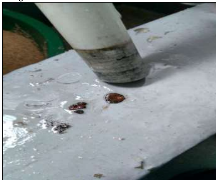
Imagen 9. Corrosión Tubería Galvanizada.
