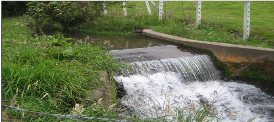
Figura 1. Fuente de captación Río Frio para la planta Galán
