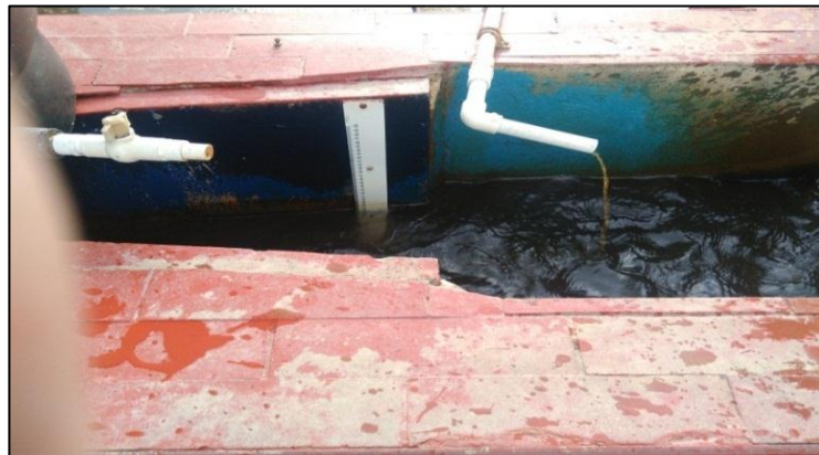
Figura 9. Canaleta Parshall de la planta Galán
