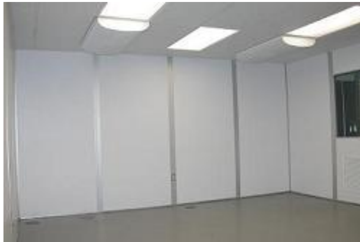
Figura 38. Ubicación de las luminarias en el interior de la cámara climatizada
