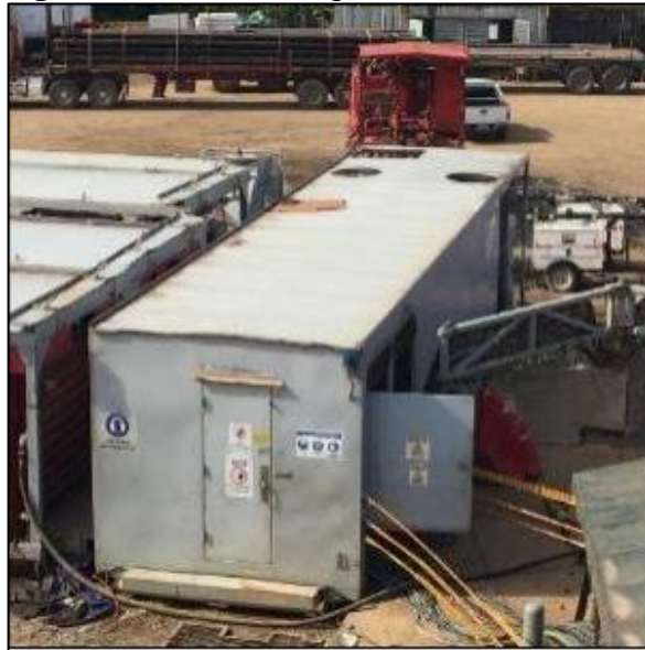
Figura 7. VFD del Rig 50.
