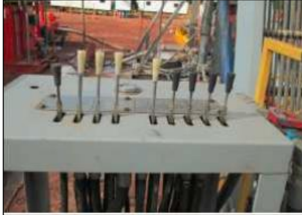
Figura 13. Controles de la HPU del Rig 50
