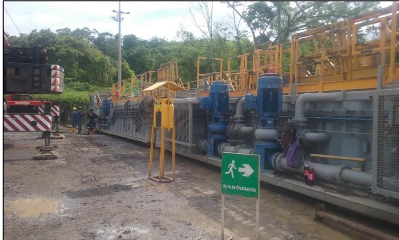
Figura 30. Tanques de lodos del Rig 50.
