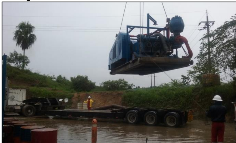
Figura 34. Rig Down de una de las bombas de lodos del Rig 50.
