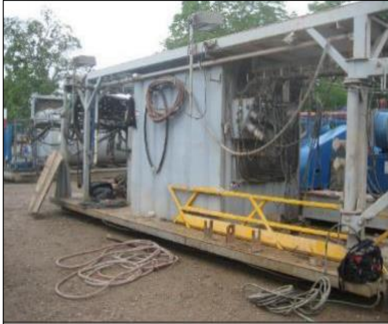
Figura 8. Utility del Rig 50.
