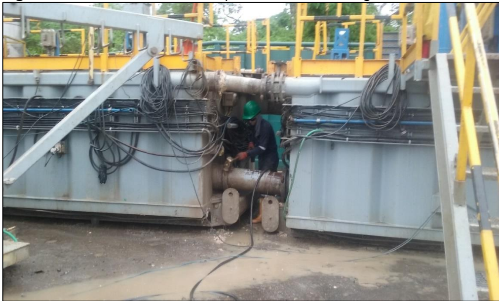
Figura 28. Conexión de los tanques de lodos del Rig 50.
