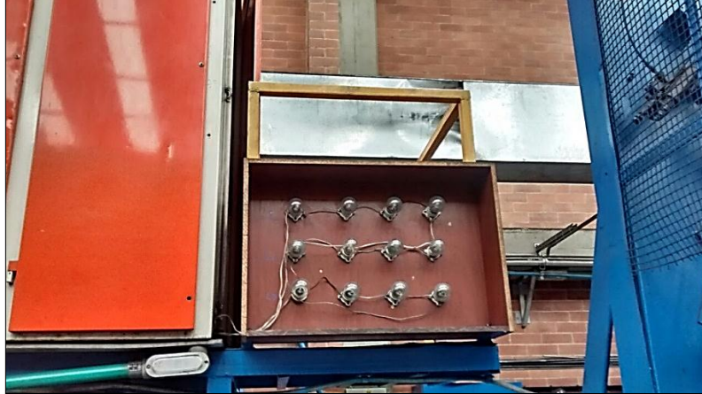
Figura 17. Tablero indicador de unidad de soldadura.
