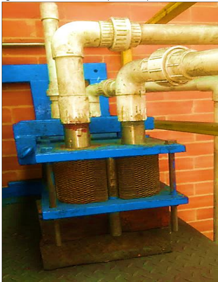
Figura 14. Intercambiador de placas del proceso.
