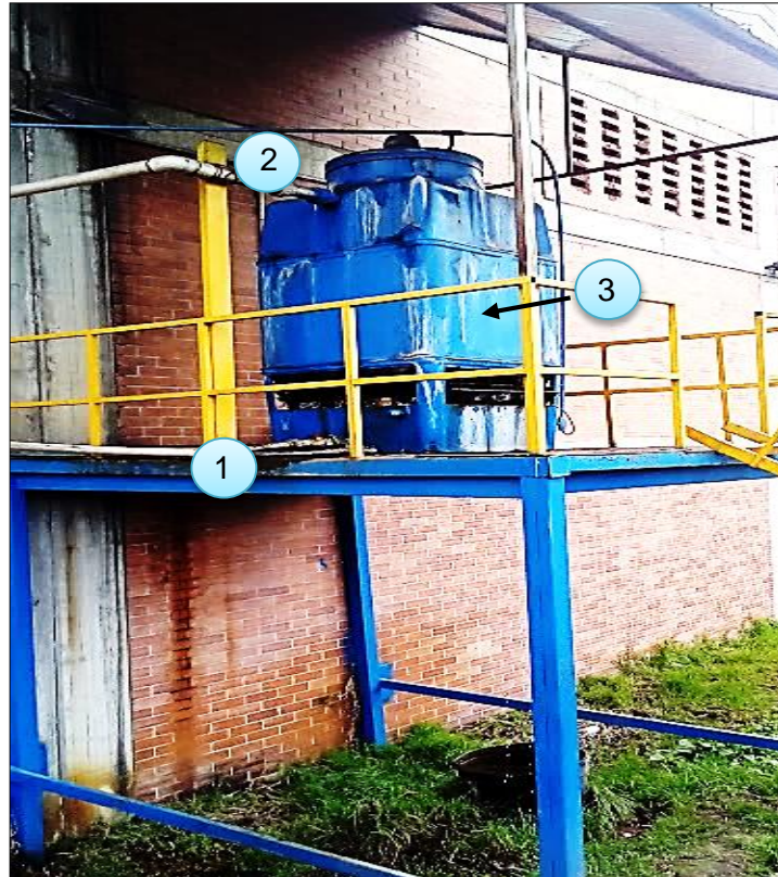
Figura 13. Torre de enfriamiento de agua de servicio.
