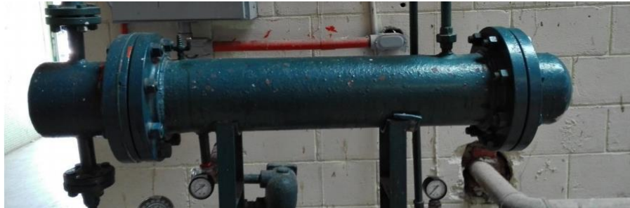
Figura 29. Intercambiador de tubos y coraza 2-4.
