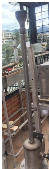
Figura 23. Quemador de gases de proceso no condensables, Tea.
