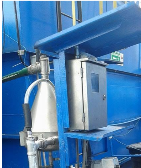
Figura 4. Tanque neutralizador de pH.
