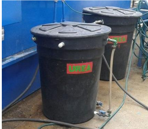
Figura 7. Tanques de urea.
