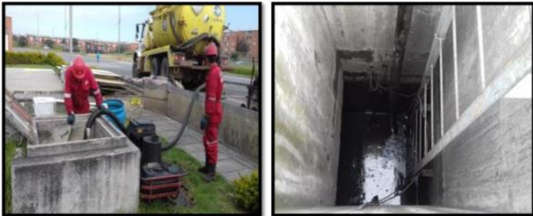
Figura 11. Limpieza tanques de almacenamiento, equilibrio y sedimentador
