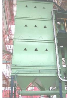
Figura 3. Silo de secado de almendras
