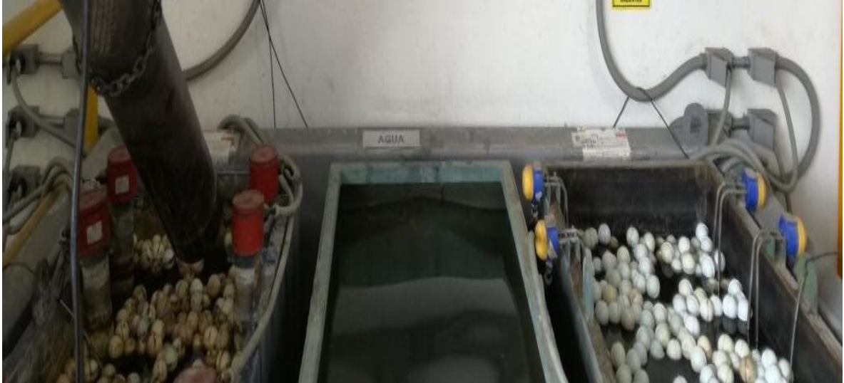
Figura 9. Tanques del proceso de fosfato.
