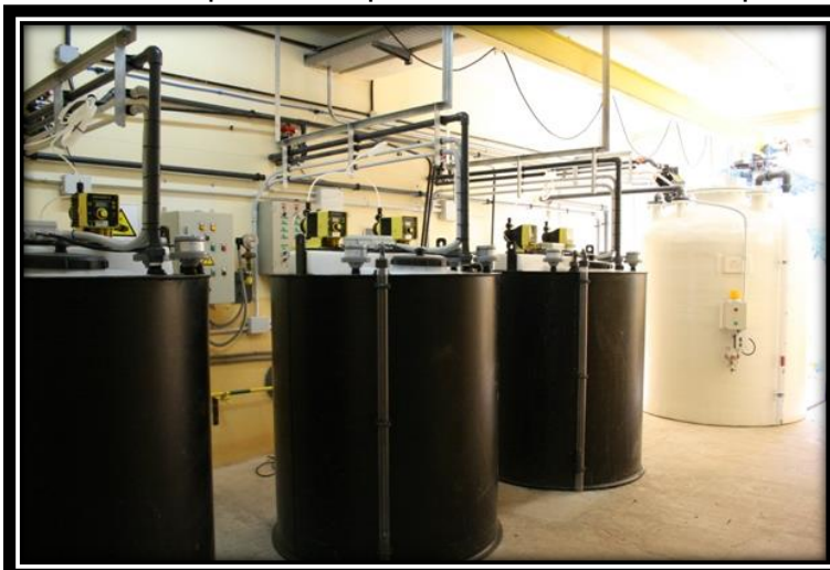
Ilustración 8. Tipo de tanque de almacenamiento para desinfectantes.
