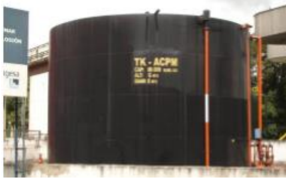
Figura 12. Tanque de almacenamiento de combustible ACPM
