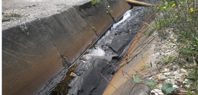
Figura 15. Vista de un tramo del canal de lixiviado
