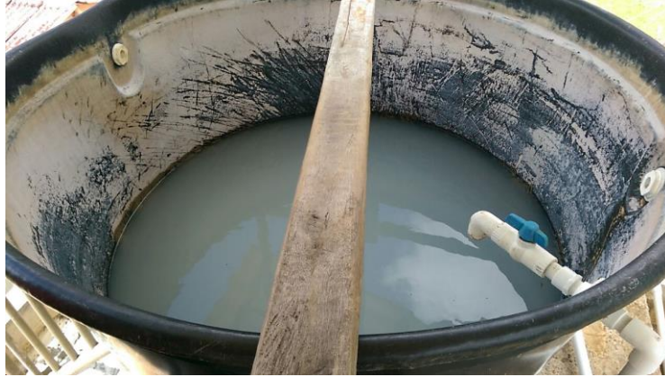
Figura 11. Sistema de dosificación de coagulante
