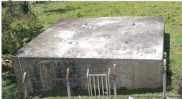
Figura 16. Tanque de almacenamiento
