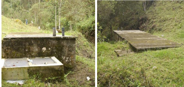
Figura 7. Desarenador sistema Coovesur
