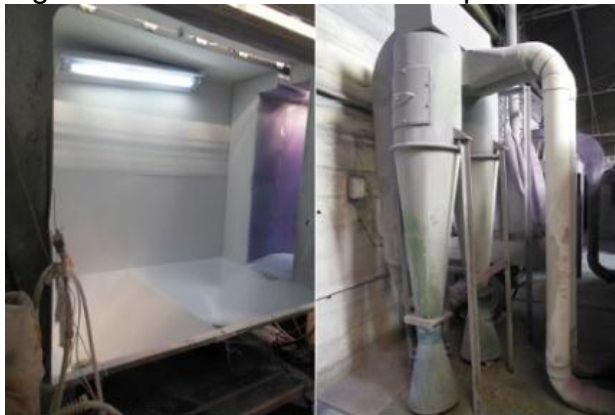
Figura 8. Cabina con ciclón recuperador
