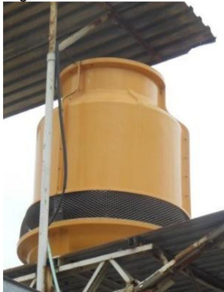
Figura 7. Torre de enfriamiento
