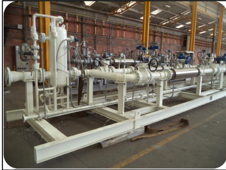
Imagen1. Skid para sistema de medición (R&F)
