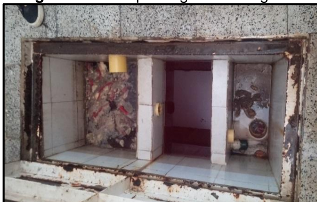
Fotografía 4. Trampa de grasa Bodega No.2
