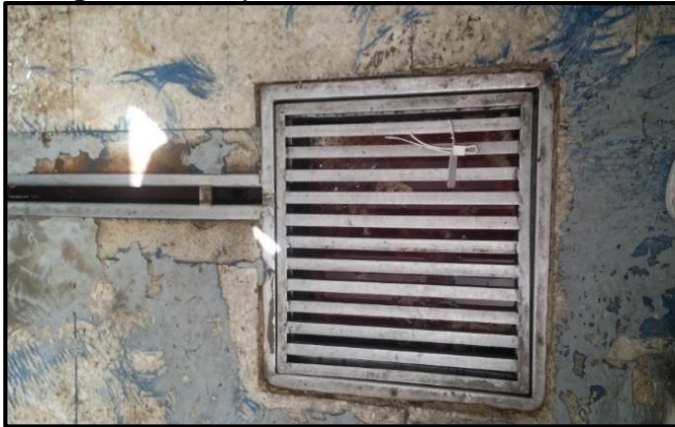
Fotografía 3. Rejilla de retención de sólidos Bodega No. 2
