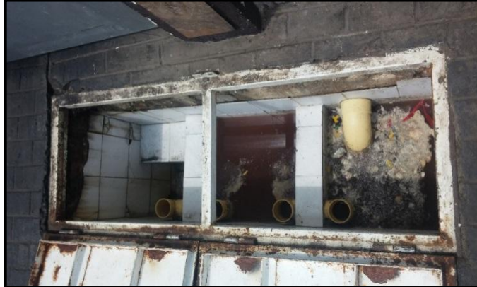
Fotografía 2. Trampa de grasa Bodega No.1
