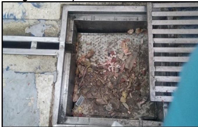
Fotografía 1. Rejilla de retención de sólidos Bodega No. 1
