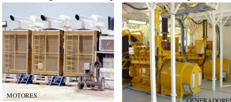
Imagen 1. Motores-generadores de energía.
