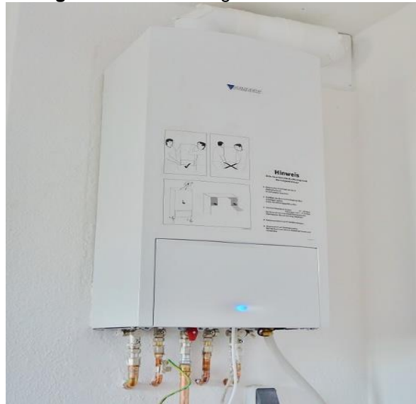
Figura 8: Caldera de gas
