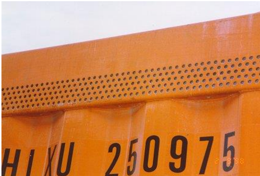
Figura 10: Ventilación vista desde afuera del contenedor
