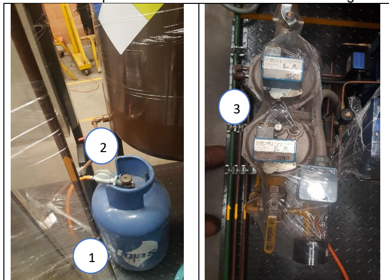
Cuadro 9. Componentes de control de alimentación a gas
