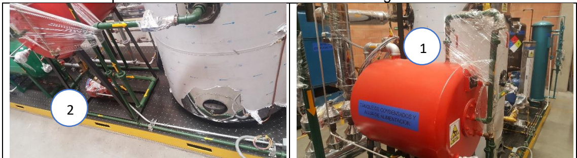
Cuadro 10. Componentes de control de alimentación de agua a caldera
