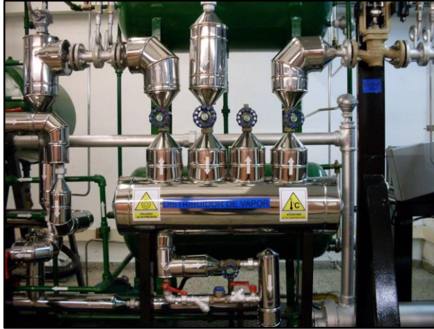
Figura 13. Distribuidor de vapor.
