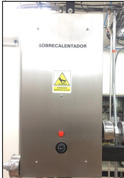
Figura 11. Sobre calentador planta térmica.
