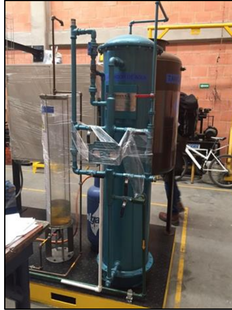
Fuente. Fotografía tomada en planta de Ingenium.
