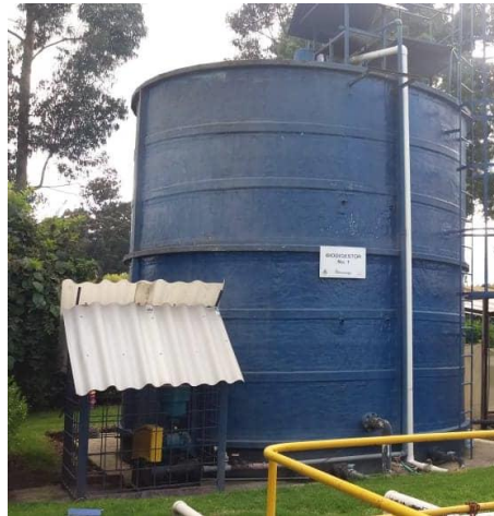
Imagen 5. Biodigestor con sistema de inyección de aire por pistón.
