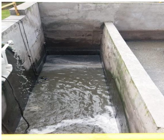
Imagen 4. Tanque de homogenización.
