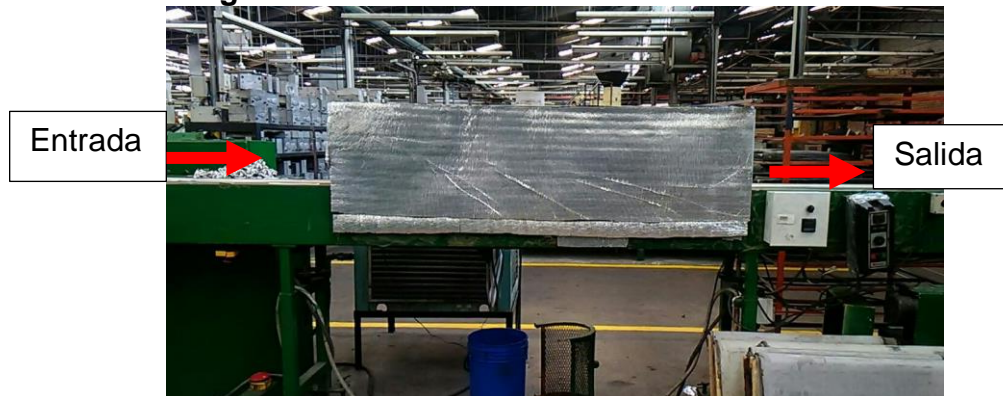
Imagen 11. Túnel de enfriamiento actual.
