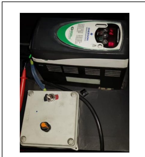
Figura 51. Variador de frecuencia.
