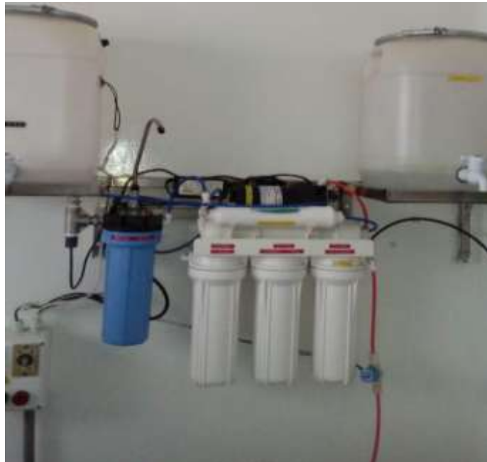
Imagen 4. Planta de tratamiento de agua
