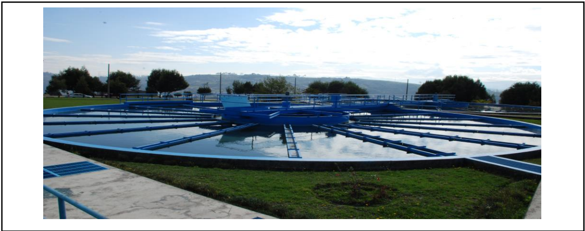
Imagen 4. Tratamiento de aguas.
