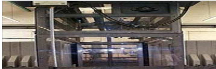
Imagen 24. Limpieza de filtro-prensa
