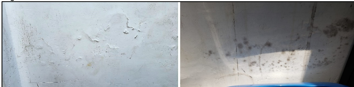
Figura 11. Deterioro material de construcción.
