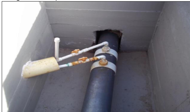
Figura 6. Punto de inyección de coagulante y toma de agua cruda para laboratorio.
