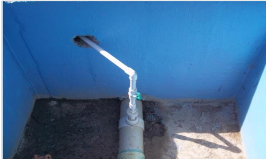
Figura 10. Punto de inyección de hipoclorito de calcio al 70%.
