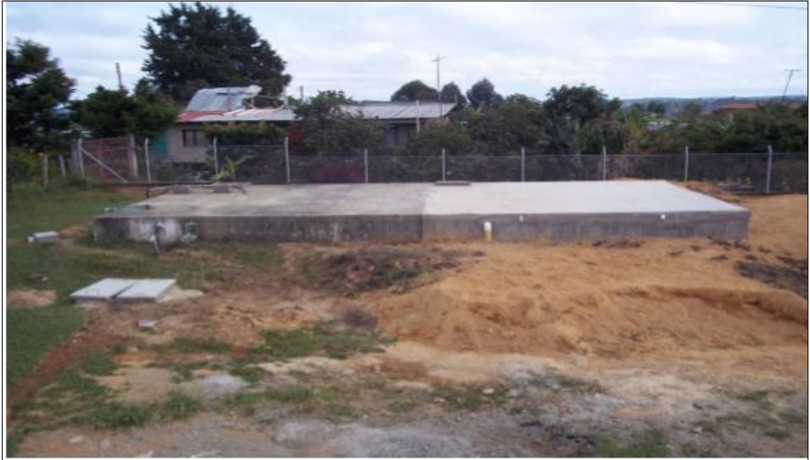
Figura 11. Tanques de almacenamiento.
