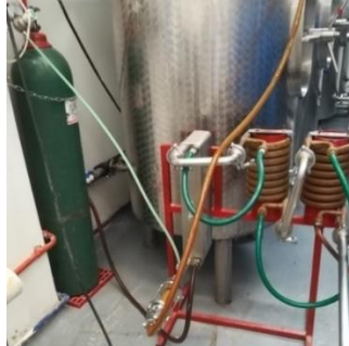
Fotografía 15. Intercambiador de calor para enfriar el mosto.
