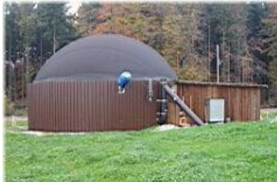
Ilustración 13. Tanque almacenamiento tradicional y cúpula de polietileno
