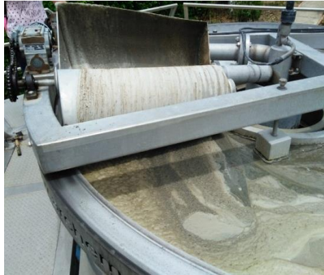
Ilustración 4. Extracción de lodos del reactor DAF
