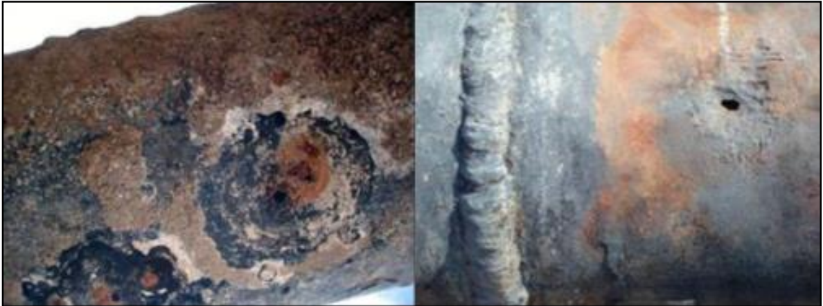
Figura 21. Representación de la corrosión tipo picadura.
